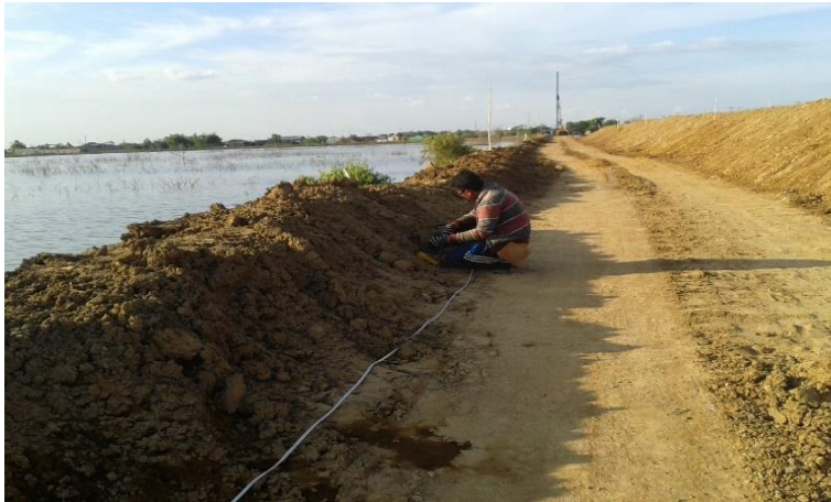
Gambar 4.10 Kondisi tanggul pada saat pengambil data lintasan 2
