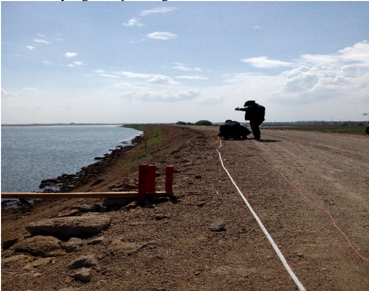
Gambar 4.14 Kondisi tanggul pada saat pengambil data lintasan 4
