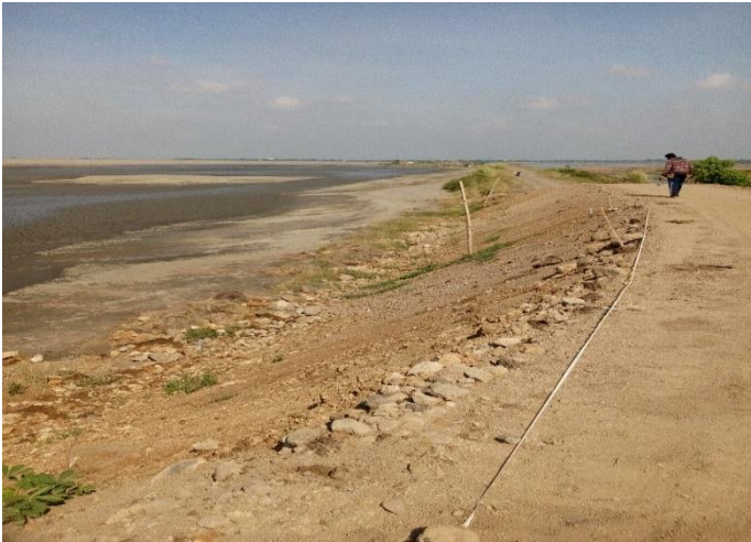
Gambar 4.12 Kondisi tanggul pada saat pengambil data lintasan 3
