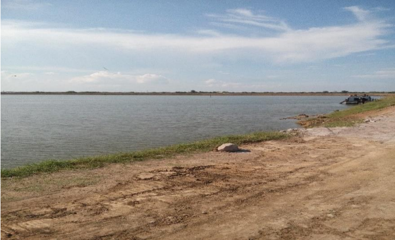
Gambar 4.16 Kondisi tanggul pada saat pengambil data lintasan 5
