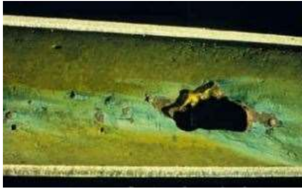
Gambar 2.6 Korosi Erosi (Hakim, 2011)
