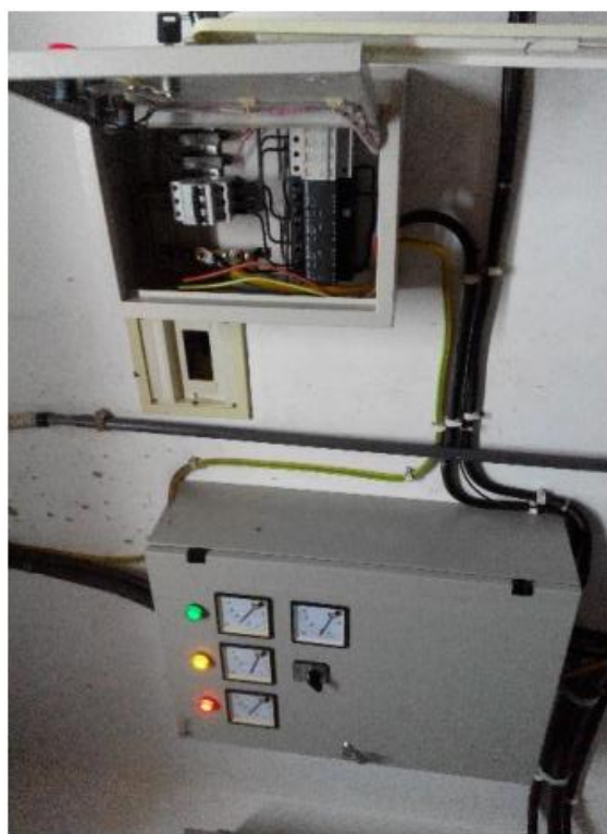
Gambar F.95 Kotak Panel Listrik dengan Fungsi Circuit Breaker
