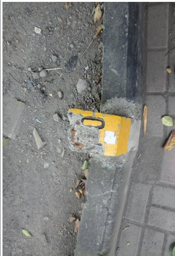
Gambar F.100 Patok Penanda Kabel Fiber Optic (Kondisi Rusak)
