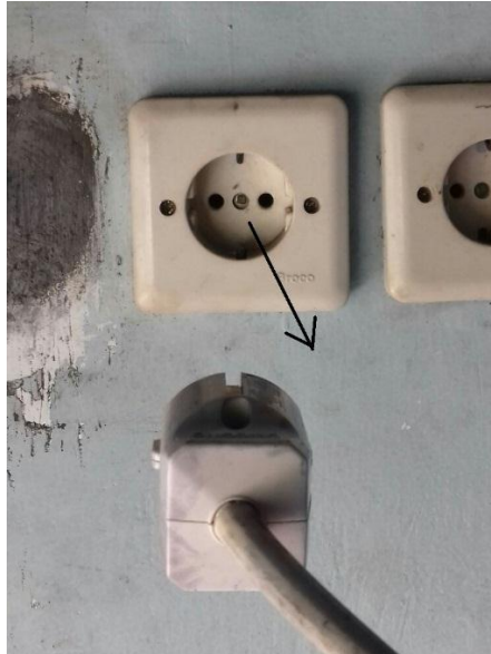
Gambar 3. 17. Memutuskan hubungan arus dengan pompa
