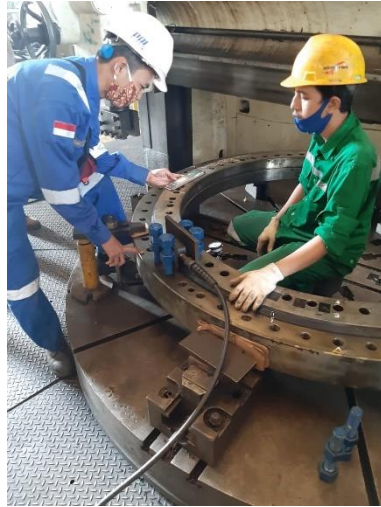
Pengujian kontak clearance (celah) Mean Ring Bearing (MRB)
