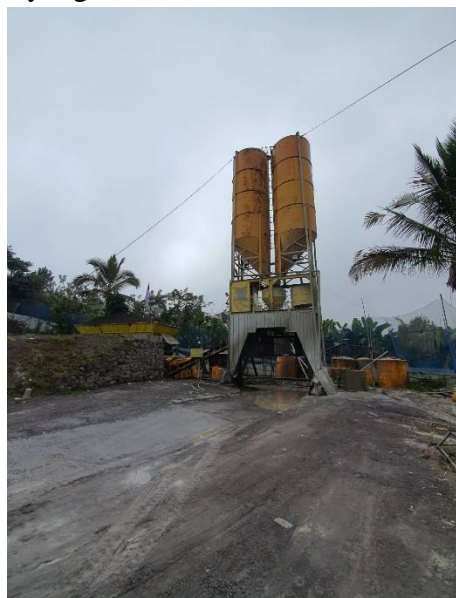
Gambar 2.17 Batching Plant (sumber: Dokumentasi Pribadi)
