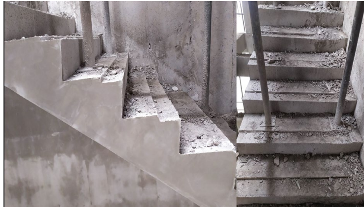
Gambar 6.2 Pemasangan Aluminium Formwork yang Mengakibatkan Cacat pada Hasil Cetakan Tangga
