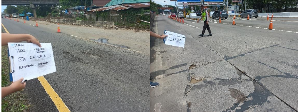
Gambar III.17 Temuan Inspeksi Infrastruktur Jalan Tol
