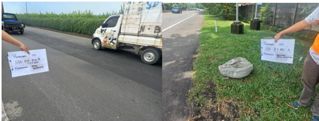
Gambar III.15 Temuan Inspeksi Heavy Maintenance
