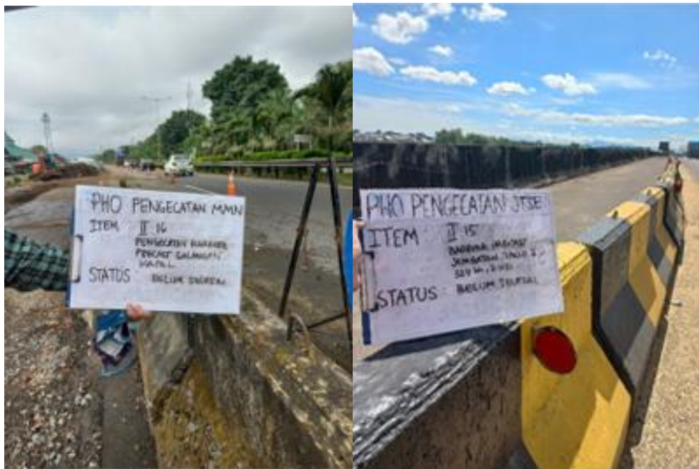
Gambar III.13 Temuan Inspeksi PHO Pengecatan
