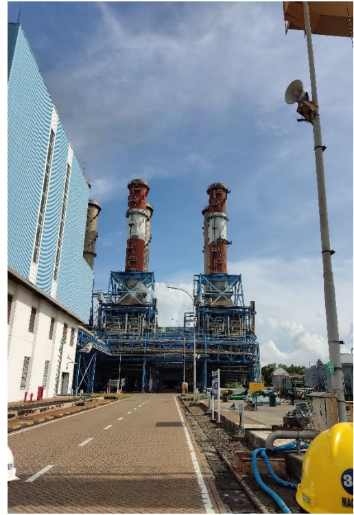
Tampak Depan HRSG Blok 3
