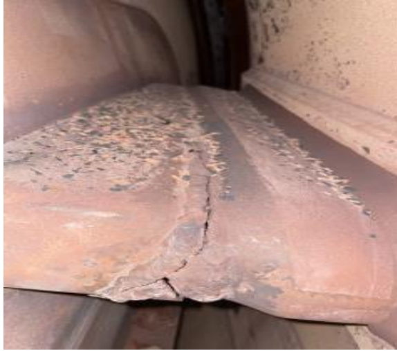
Gambar 4.32 Temuan crack pada exhaust cylinder
