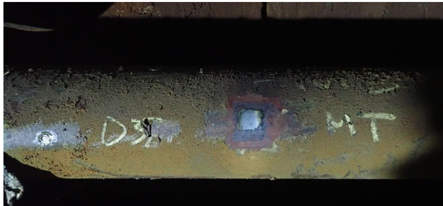
Gambar 4.19 Gambar terak pada dinding tube boiler
