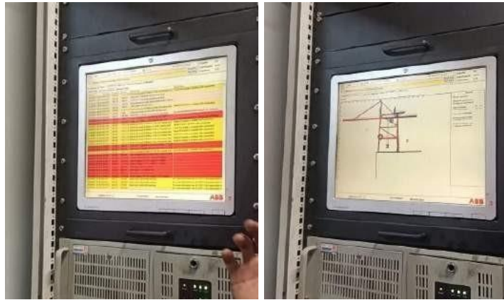
Gambar 4.25 LCD pada Electrical Room CC 05
