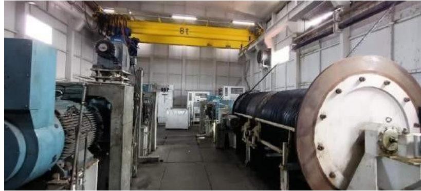
Gambar 4.23 Tampak dalam machinery room
