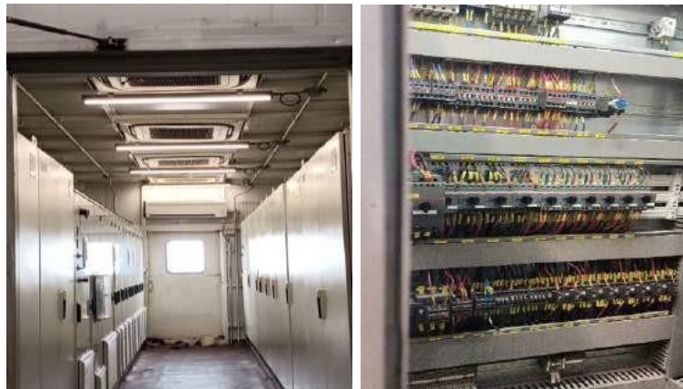
Gambar 4.24 Tampak dalam electrical room
