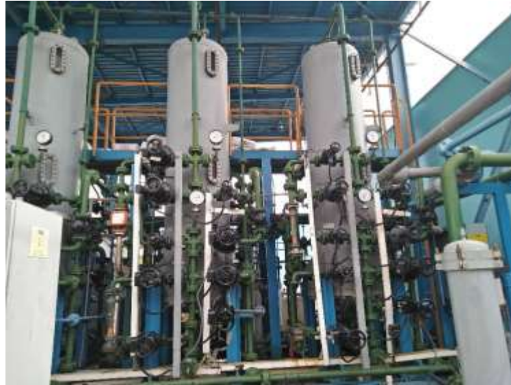
Gambar 4. 7 Pre Filter dan Mix Bed
