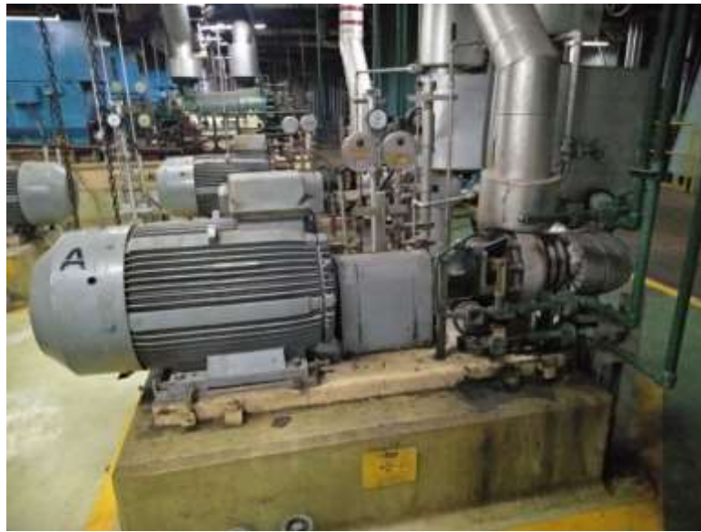
Gambar 4. 14 Pompa dan Motor Penggerak (Sumber : PT. PJB )
