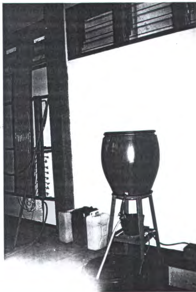
Foto 4. Bak Influen, Bak Overflow, dan Bak Penampung Overflow
