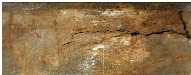
Gambar 2.10 Stress corrosion cracking pada pipa (Wisdatika, 2012)
