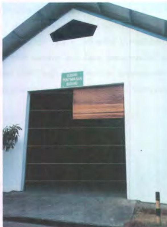
Gambar 4.4. Gudang Penyimpanan Barang di Salah Satu Jembatan Timbang yang Tidak Digunakan
