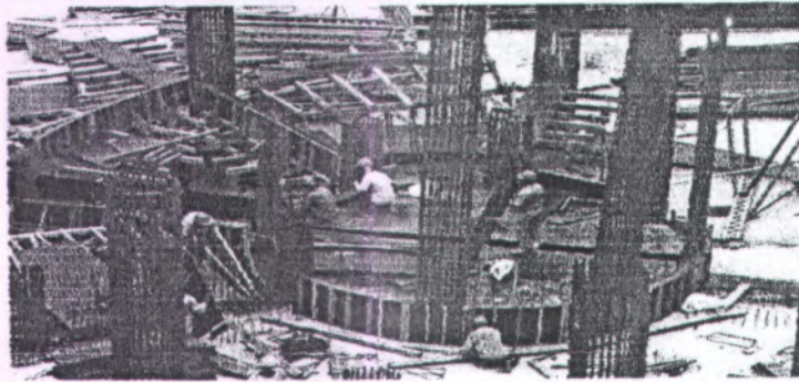
Gambar 4.13 Pemasangan Bekisting Plat dan Balok ( Sumber : Data Shop Drawing Pasar Atum Mall )
