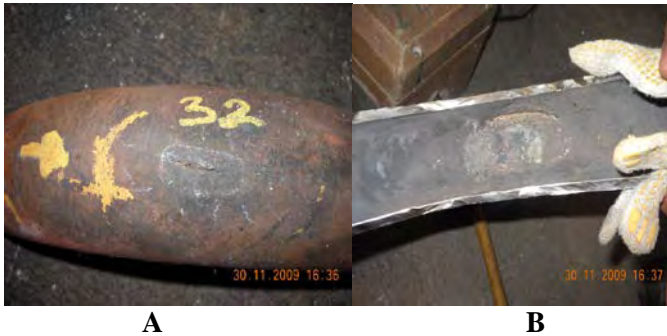
Gambar 4.3 Pengelembungan pada U-Bend superheater tube (A). Penumpukan deposit pada bagian dalam U-Bend superheater tube (B)
