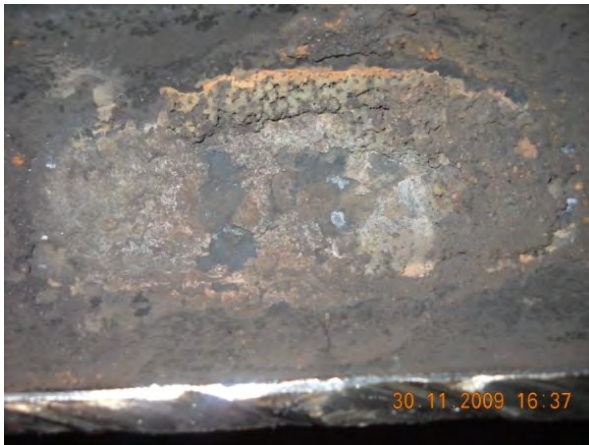
Gambar 4.8 Bekas endapan deposit pada U-bend superheater tube Boiler 31F-28
