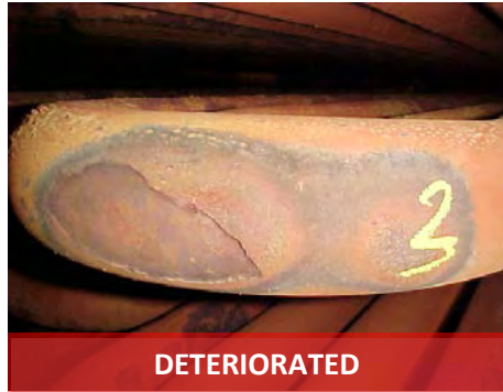
Gambar 2.3 Deteriorated pada U-Bend Section [13]
