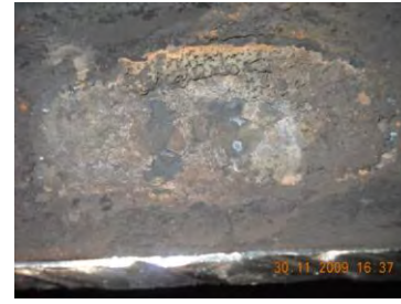
Gambar 4. Bekas endapan deposit pada U-bend superheater tube Boiler 31F-28
