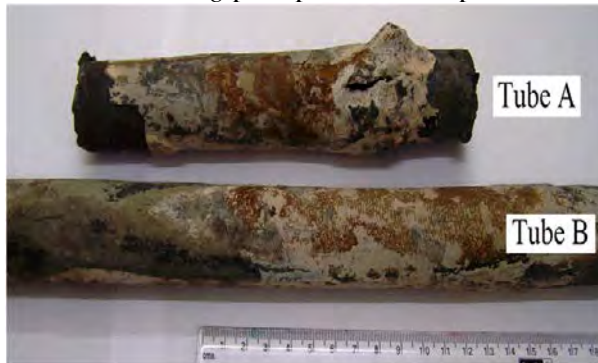
Gambar 2.13 Foto yang menunjukkan superheater tube yang mengalami kegagalan (identifikasi tube A) pecahnya superheater tube dan tabung lainnya (identifikasi tube B) penipisan lokal. [6]
