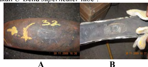
Gambar 1. Penggelembungan pada U-Bend superheater tube (A). Penumpukan deposit pada bagian dalam U-Bend superheater tube (B)
