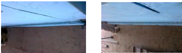
Gambar 3.4 kemiringan yang terjadi pada peletakan box
