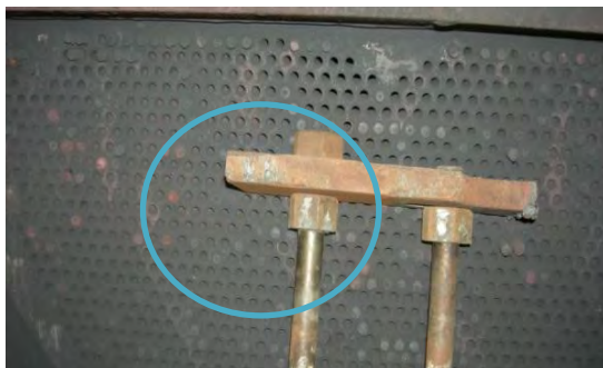
Gambar 2.10 Plugging pada tube kondensor
