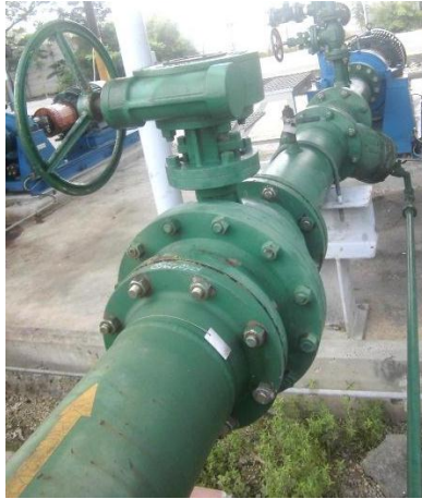
Gambar 4.18 Ball valve pada pipa suction
