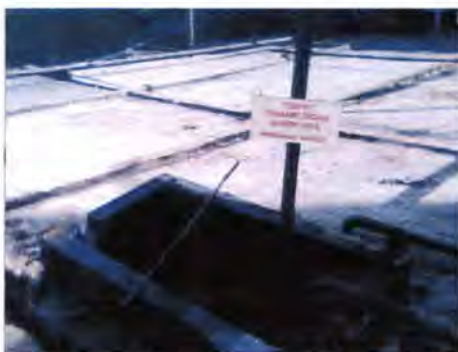
Gambar 2.4 Bak Penampung Phenolic Water (Sumber: Dokumen Pribadi PT XYZ)
