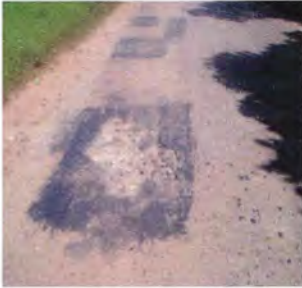
Kondisi kerusakan jalan pada STA96+500
