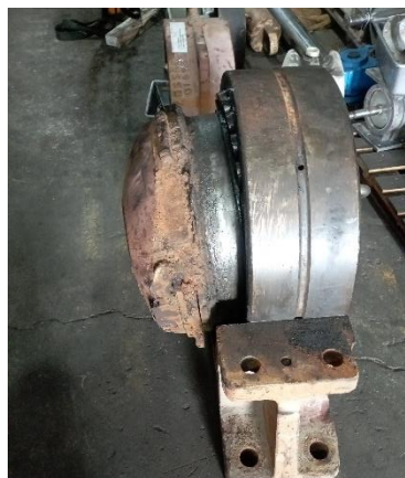
Gambar 4.19 House Bearing (Sumber: Dokumentasi Pribadi 2024)
