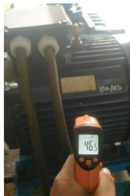
Gambar 5.27 Pengukuran Temperatur Motor Penggerak
