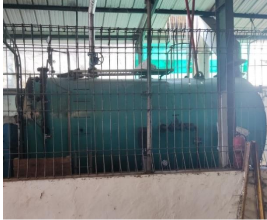
Gambar 4. 9 Boiler di PT Panca Patriot Prima
