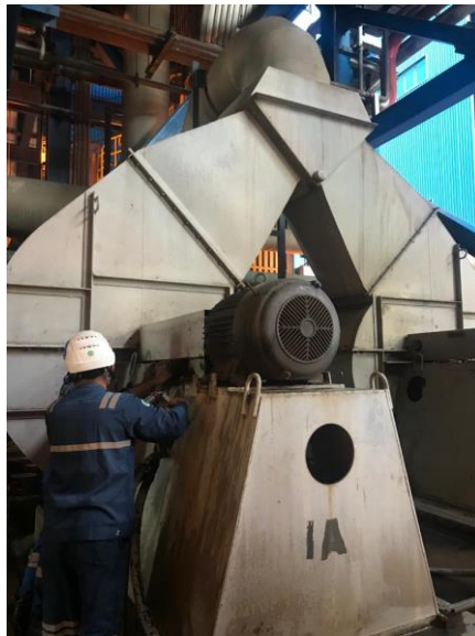
Gambar 5.38 Mill Seal Air Fan
