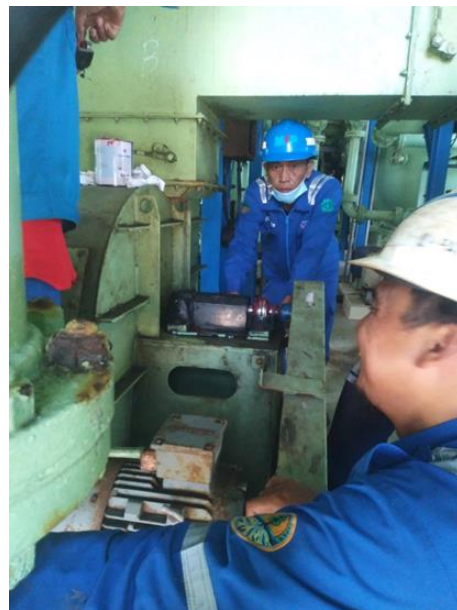
Pengecekan kondisi alat pada pompa Decaborator
