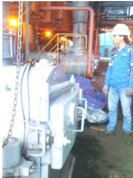
Pengecekan kondisi kebersihan peralatan pada Coal Feeder
