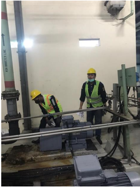
Preventive maintenance pemeriksaan pada pengecekan kebersihan alat
