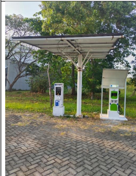
Charging station di STP, terletak di depan gedung STP
