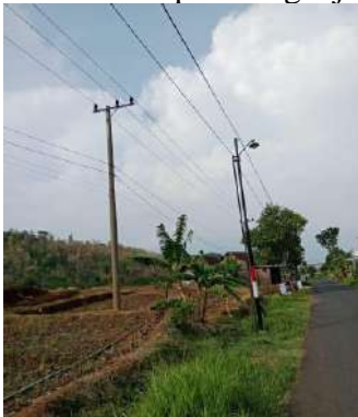
Gambar 4. 83 Jaringan Listrik (Sumber: Survei Primer, 2024)
