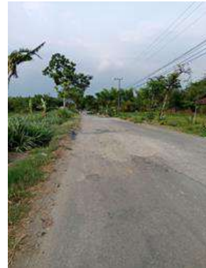
Gambar 4. 55 Kondisi Jalan (Sumber: Survei Primer, 2024)
