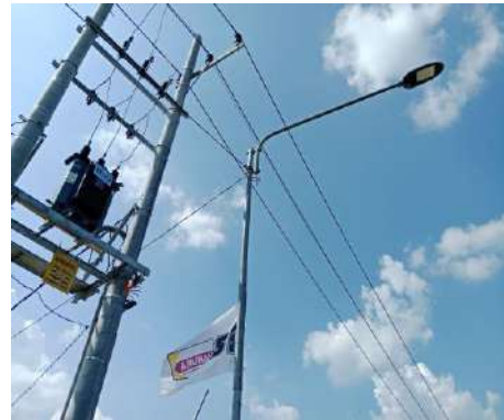
Gambar 4. 84 Jaringan Listrik (Sumber: Survei Primer, 2024)
