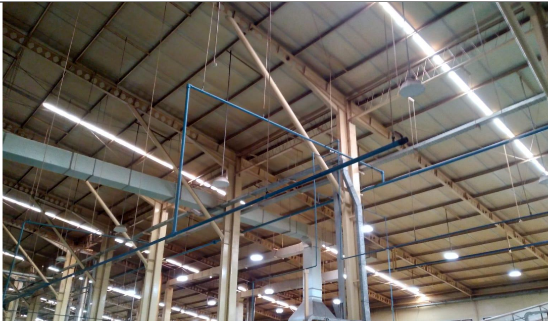
Oservasi dan mapping sistem udara bertekanan pada plant PSPD
