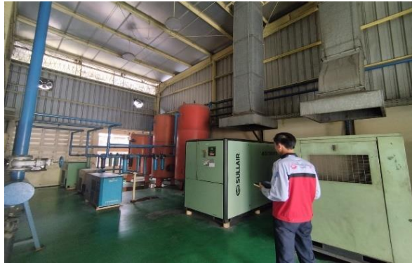
Gambar 3. 7 Observasi Compressor Room (Sumber: Penulis)
