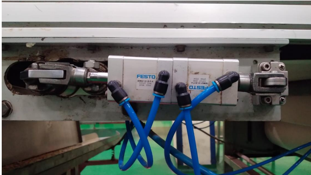
Observasi pada sistem pneumatic di line production (Adjustable Tracker)
