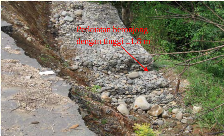
Gambar 1.4 Kondisi existing bahu jalan dengan penanganan sementara menggunakan beronjong pada bagian bawah jurang
