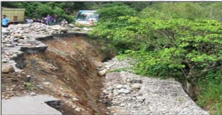
Gambar 1.3 Ketinggian longsor \pm 6 m dari permukaan jalan dengan lebar badan jalan yang terpotong \pm 1 m
