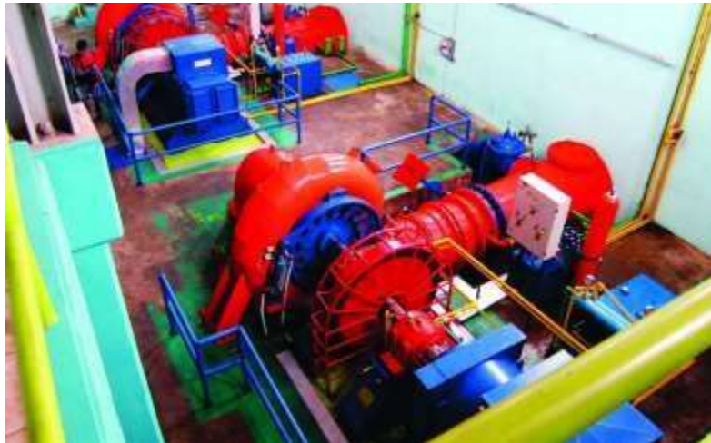
Gambar 2. 19 PLTMH (Sumber : Dokumentasi Pribadi)
