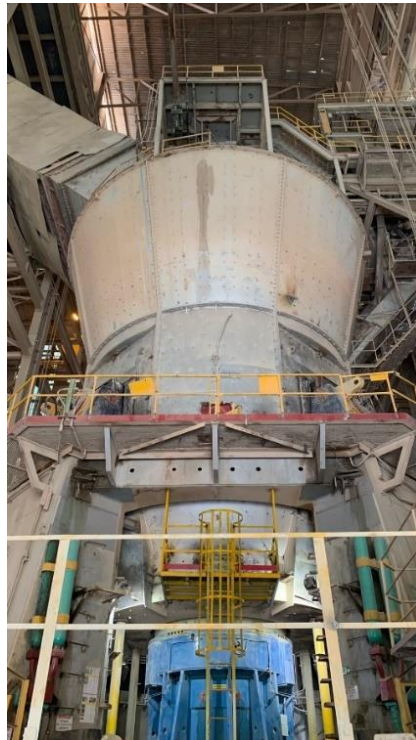
Gambar 2.8 Mesin VRM Raw Mill (Sumber : Dokumen Pribadi, 2024)
