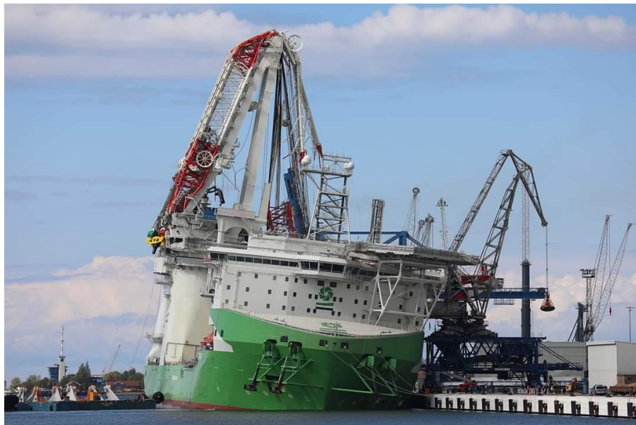
Gambar 1.2 Sebuah Crane Runtuh pada saat Menjalani Tes Beban
