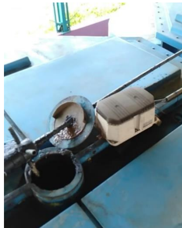
Gambar 4. 5 Pipa Blower yang Menyalurkan Udara
