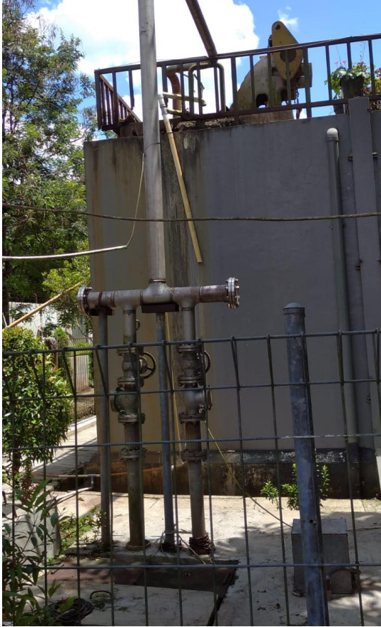
Unit Inlet dan Sedimentasi I IPAL RSUD Banyumas
