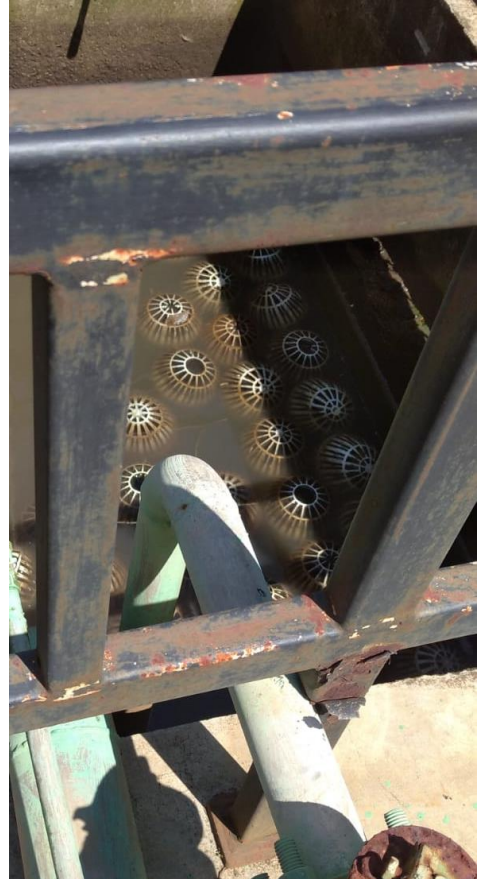
Media Bioball pada fluidized bed biofilter reactor IPAL RSUD
