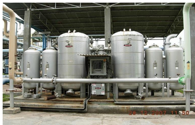
Gambar 4. 9 Air Dryer (Sumber : Dokumentasi Pertamina, 2007)
