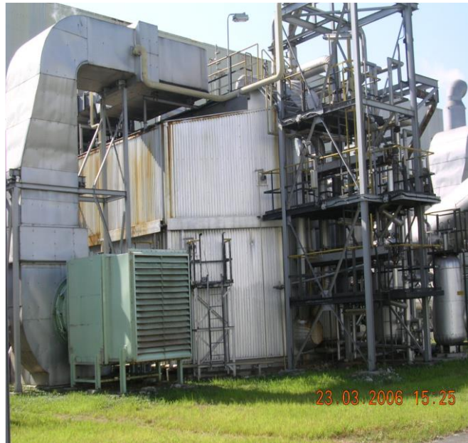
Gambar 4. 3 Boiler (Sumber : Dokumentasi Pertamina, 2006)
