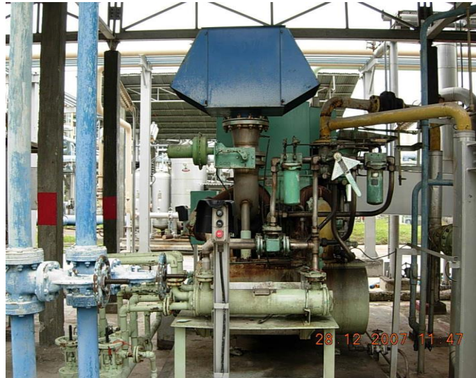
Gambar 4. 8 Air Compressor (Sumber : Dokumentasi Pertamina, 2007)
