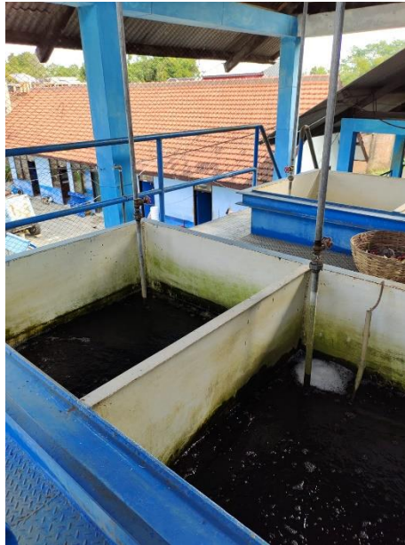
Gambar 2.9 Unit Filtrasi IPAM Tegal Besar Sumber: Dokumentasi Pribadi
