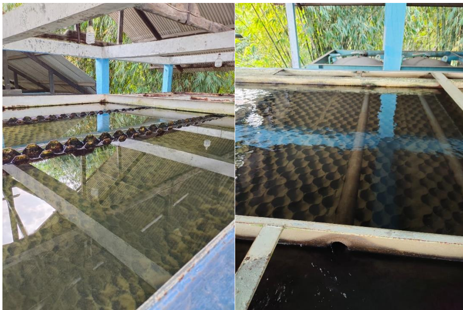
Gambar 2.8 Unit Sedimentasi IPAM Tegal Besar Sumber: Dokumentasi Pribadi
