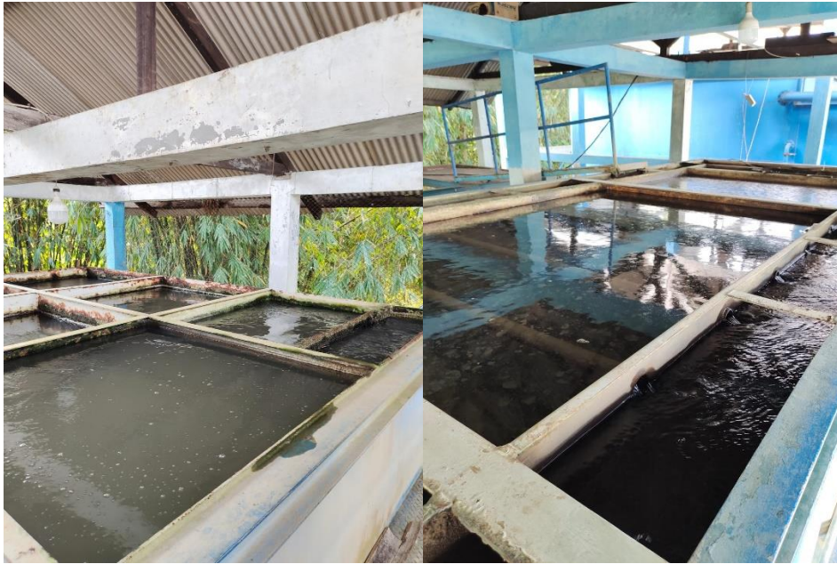
Gambar 2.7 Unit Koagulasi-Flokulasi IPAM Tegal Besar Sumber: Dokumentasi Pribadi
