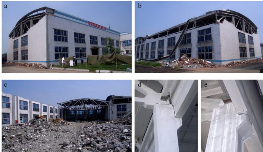
Gambar 2.1 Kerusakan di China Pada Gedung Beton Pracetak (Zhao dkk., 2009)
