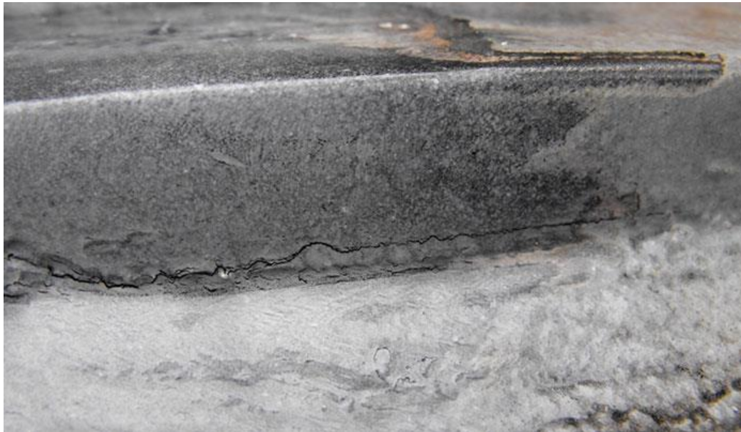
Gambar 2. 14 Cacat Retak (Ristyanto et al., 2014)
