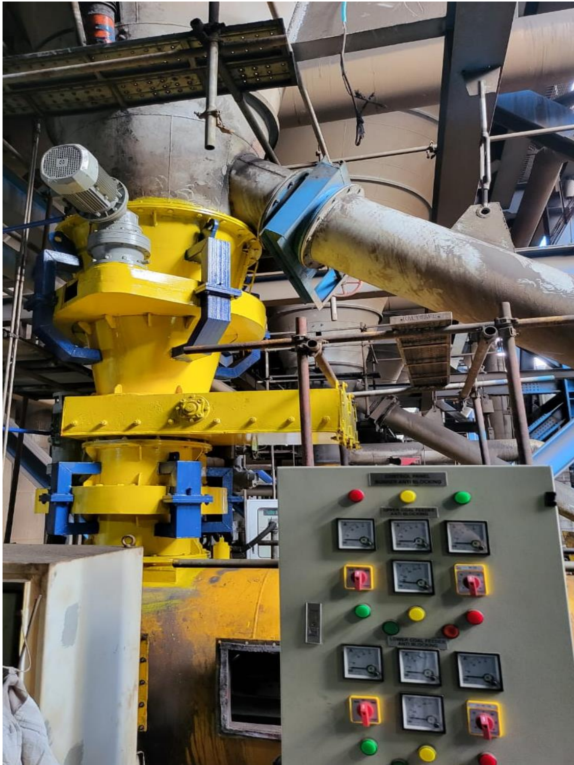
Gambar 4.3 Rotary Anti Blocking Yang Terpasang Di Unit PLTU Pangkalan Susu
