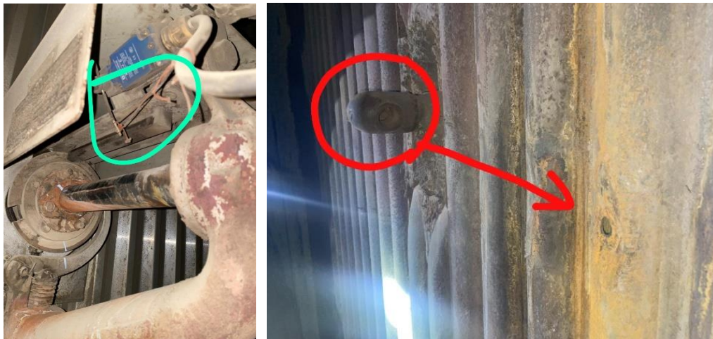
Gambar 4.14 Lokasi sootblower IR20 tidak beroperasi normal
