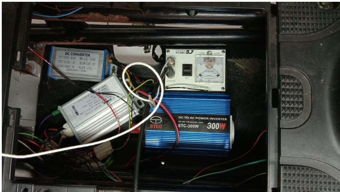
Gambar 4.10 Posisi penempatan inverter dan power supply
