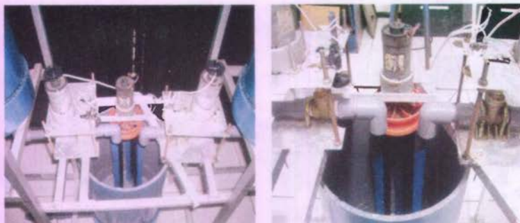
Gambar Control Valve dan Mixer
