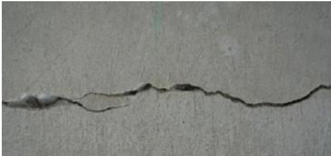
Gambar 2. 3 Fenomena crack pada dinding bangunan (Cha et al., 2017)
