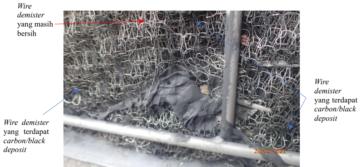
Gambar 4.10 Carbon/black deposit yang ditemukan pada demister
