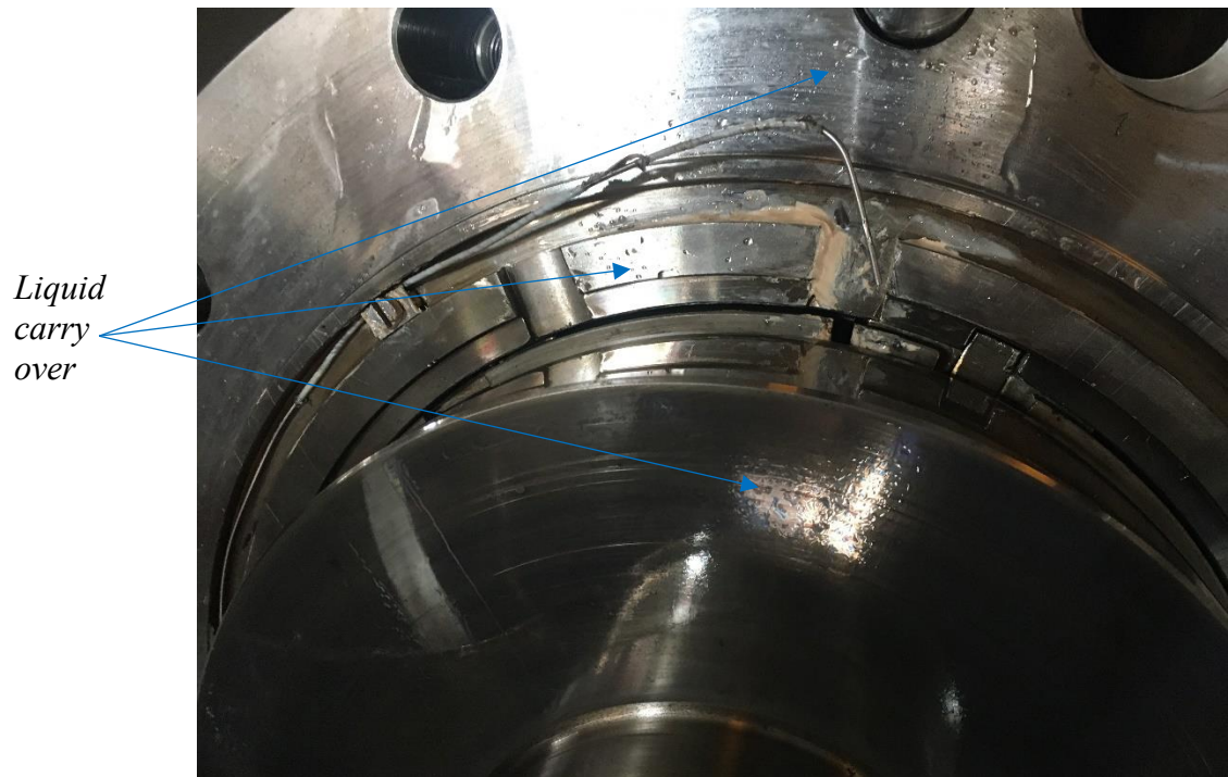
Gambar 4.7 Kondensat liquid carry over pada sisi inboard compressor
