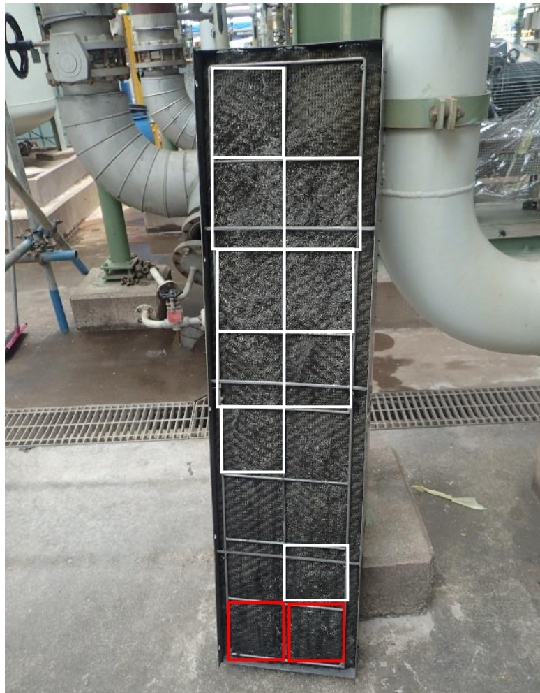
Gambar 4.12 Posisi dari bagian demister yang mengalami kerusakan (kotak putih : wire demister mengalami kerusakan, kotak merah : Terdapat carbon/black deposit pada wire mesh )
