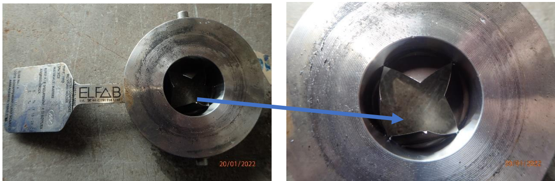
Gambar 1.5 Temuan Rupture Disc Failure tanggal 20 Januari 2022
