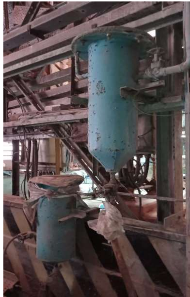
Gambar 3.7 Air Receiver (Sumber: Dokumentasi Perusahaan)
