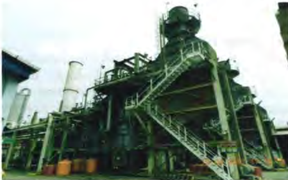
Gambar 2.1 HRSG PT. GRESIK GASES and POWER INDONESIA
