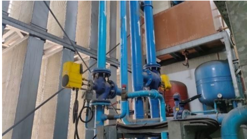
Gambar 4. 20 Saluran Pipa Air Radiator Sumber:Dokumentasi Pribadi
