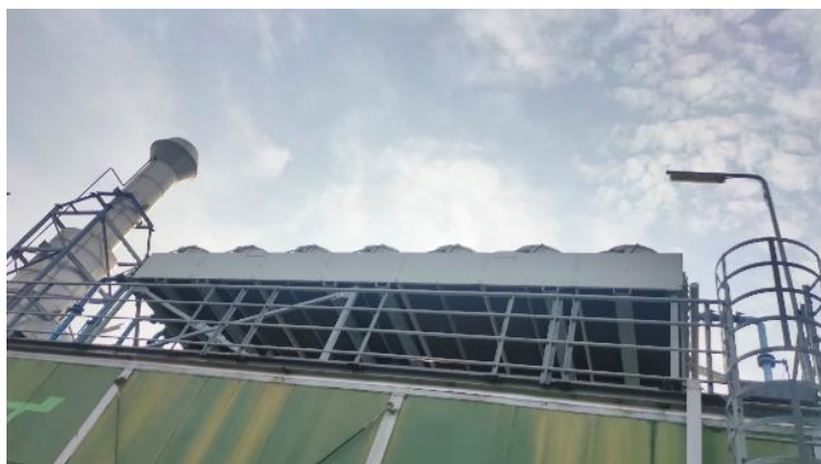
Gambar 4. 7 Dry Cooler Sumber:Dokumentasi Pribadi
