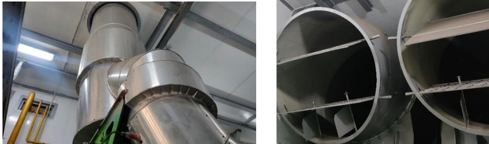
Gambar 4. 16 Saluran Udara Pada PLTMG
