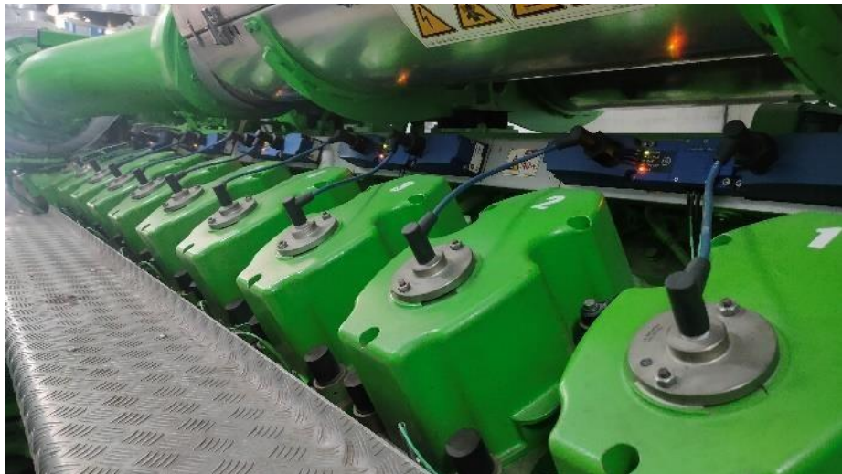
Gambar 4. 11 Cylinder Pembakaran PLTMG
