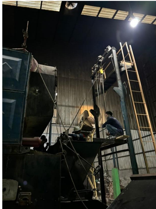
Gambar 4. 19 Instalasi Coal Gate (Sumber: Dokumentasi Pribadi)
