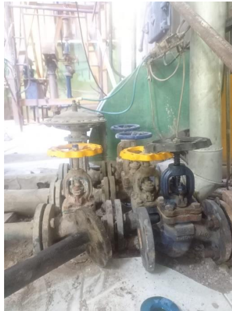
Gambar 4. 6 Blowdown Valve (Sumber: Dokumentasi Pribadi)
