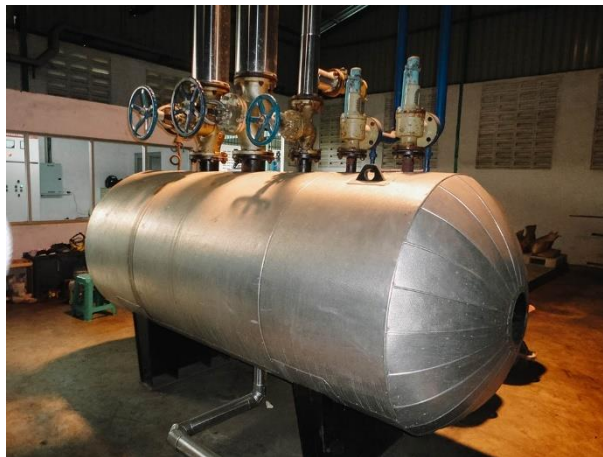
Gambar 4. 30 Storage Tank (Sumber: Dokumentasi Pribadi)
