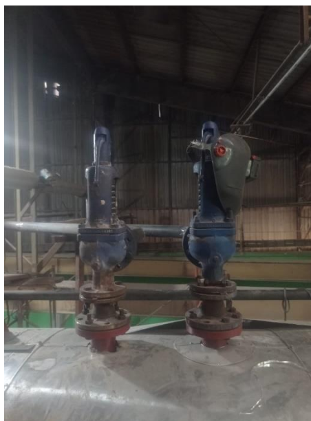
Gambar 4. 5 Safety Valve (Sumber: Dokumentasi Pribadi)
