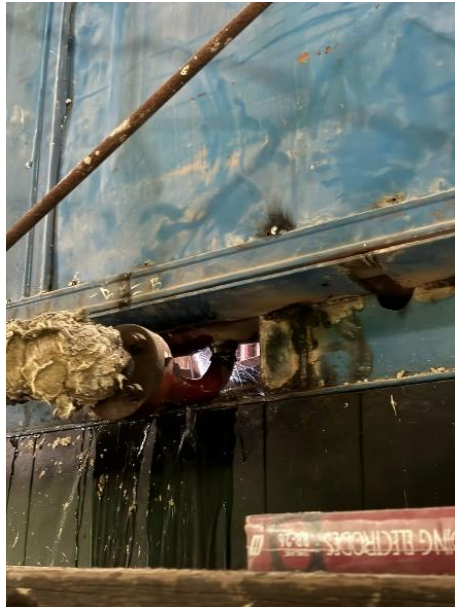
Gambar 4. 38 Indikasi Kebocoran (Sumber: Dokumentasi Pribadi)
