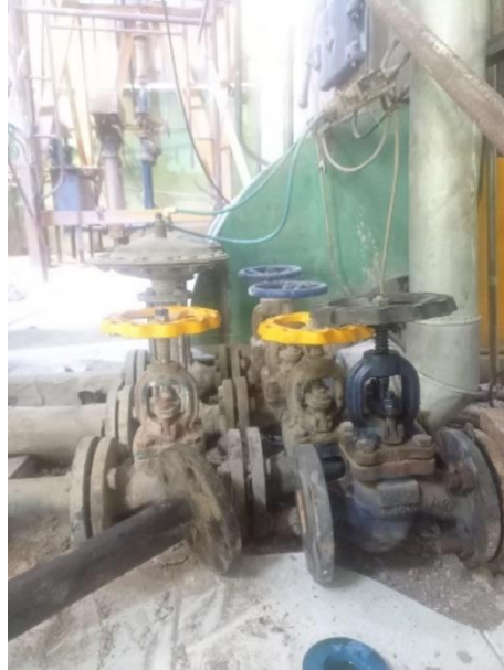
Gambar 4. 29 Shut – off Valve (Sumber: Dokumentasi Pribadi)
