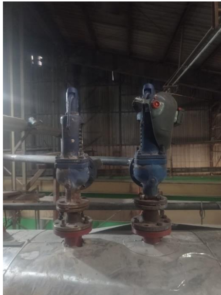
Gambar 4. 28 Safety Valve (Sumber: Dokumentasi Pribadi)
