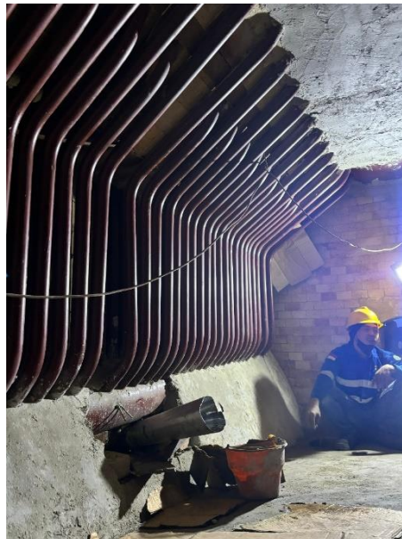
Gambar 4. 1 Tungku ( Furnace ) (Sumber: Dokumentasi Pribadi)
