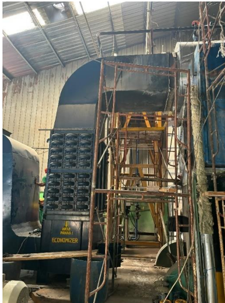
Gambar 4. 4 Economizer (Sumber: Dokumentasi Pribadi)
