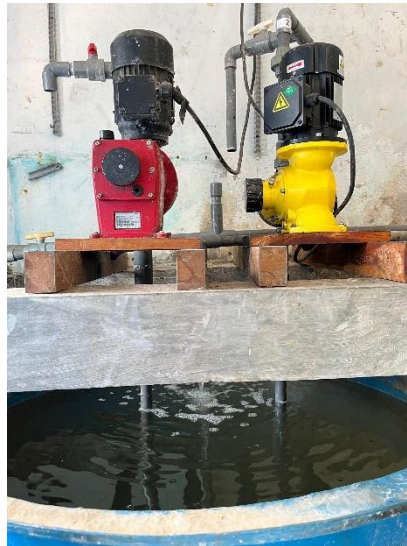
Gambar 4.2 Injeksi Tawas Cair IPAM Legundi Gresik (Sumber: Dokumentasi Penulis)
